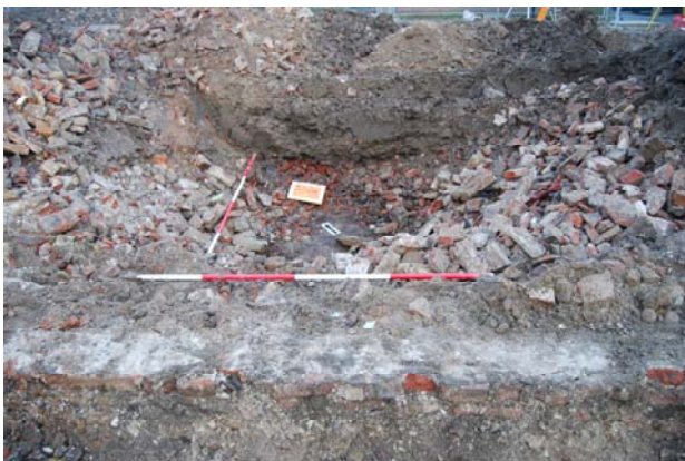
Afb. 21. Eén van de centraal gelegen kelders die tijdens de sloop van de bebouwing is volgestort met puin.
